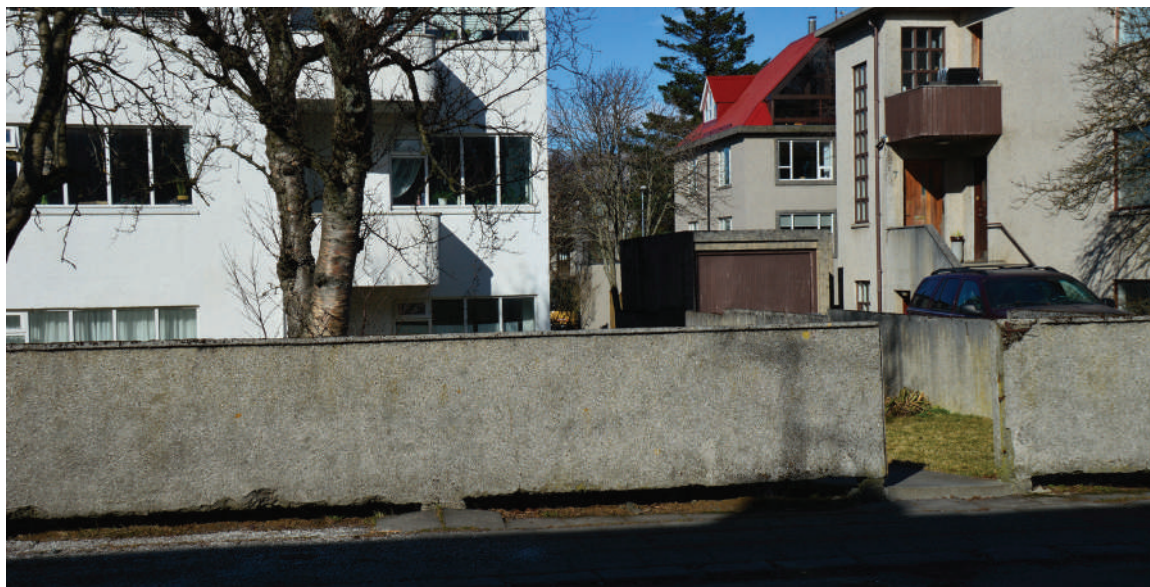
Mynd 22.12. Landsig í Norðurmýrinni í Reykjavík vegna framræslu. Mýrin hefur sigið við húsið og unnið er að viðgerð (fyrir ofan) en landið hefur sigið niður fyrir girðinguna á myndinni fyrir neðan svo að gapir undir hana.
